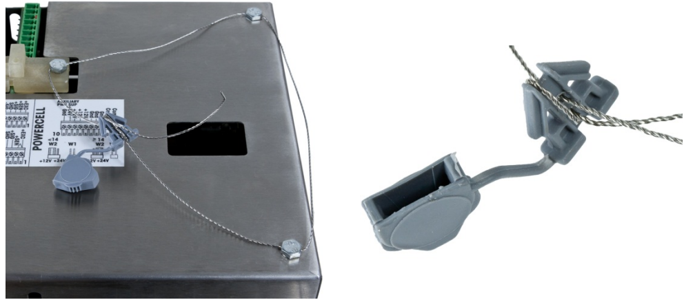
Figura 2-117: Alambre de sello instalado, alambre insertado a través del sello
